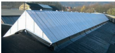
Luminator triunghiular după renovare
