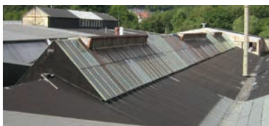
Luminator cu etrier cu geam armat cu plasă înainte de renovării
