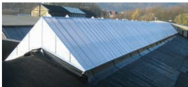
Luminator triunghiular după renovare
